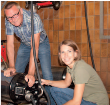
Neue Anlage mit 3 Grundfos SE1 Abwasserpumpen. Personen von links nach rechts: Patrick Link-Walter, Außendienst Wasserwirtschaft Grundfos GmbH, Claudia Kaiser, technischer Außendienst HTI Gienger
