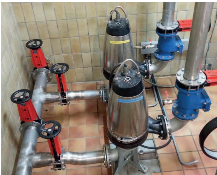
Pumpen Regenüberlaufbecken: 2 S1.80.100.40 vertikal trocken aufgestellt
